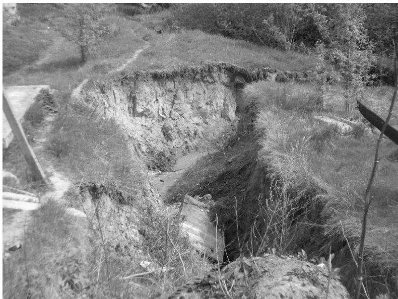
Рис. 1. Размыв в районе городской подстанции
