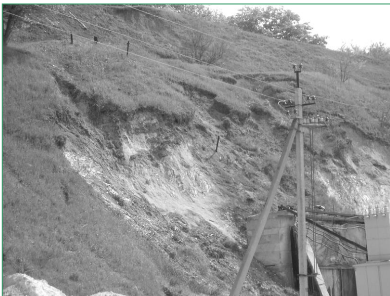
Рис. 2. Оползень в районе авторынка
